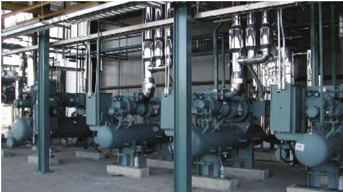
Industrial refrigeration machine room / Cuarto de máquinas de refrigeración industrial
